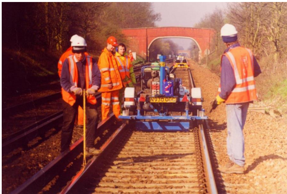
Deflectómetro de impacto en proyectos ferroviarios en operación
